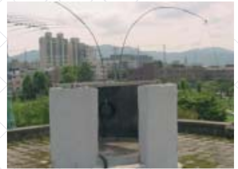
Beispielkonfiguration installiert auf Flachdach
